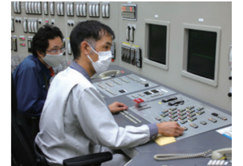
運転再開時の制御室の様子
